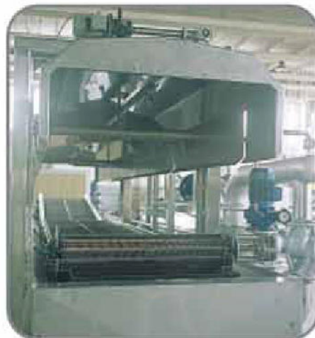
24- Particolare dell'interno friggitorie 24- Detail of fryer inside
